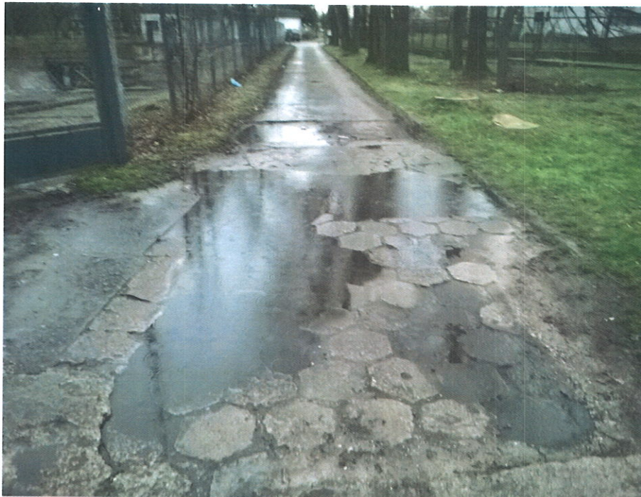
Ryc.4. Zdewastowana nawierzchnia przyległej do terenu opracowania uliczki (materiał fotograficzny własny)
